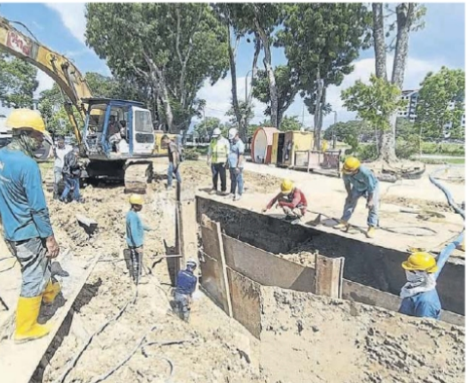
北赖河跨河管道工程如火如荼进行，工作人员都在谨慎工作。
