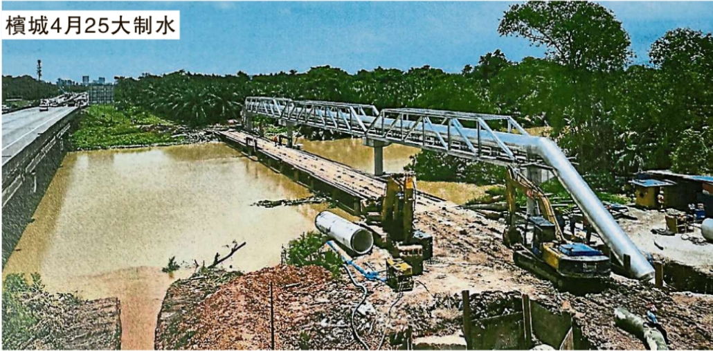
位于甘榜直落的北赖河新跨河管道也将进行最终接驳工程。（翻拍槟州水供机构图册）
