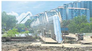
■北賴河跨河管道。
