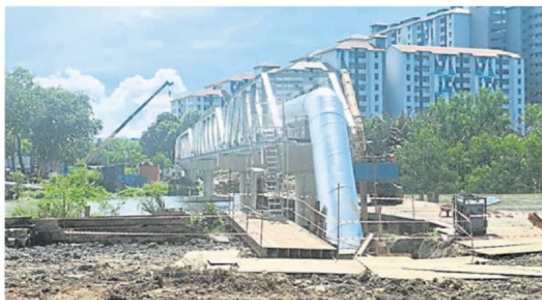
■北赖河跨河管道。
