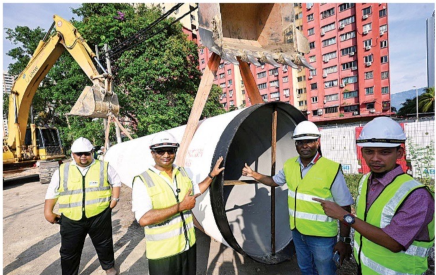
巴玛纳登(左2)巡视敦林苍祐大道旁的新输水管道铺设工程。
