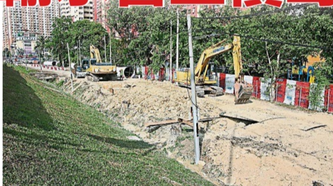
五条路至武吉南玛的新输水管铺设工程率先展开，预期2027年12月完工。（林晓慧摄）
