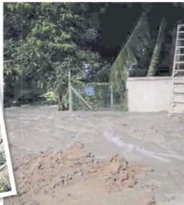
■威北双溪罗甘区发生300毫米水管爆裂事故，涉及连接至1350毫米主输水管的排水管。
