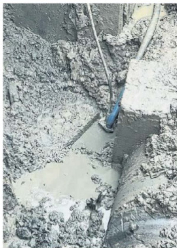
■威北区一条水管爆裂，引发突发性水供中断。
