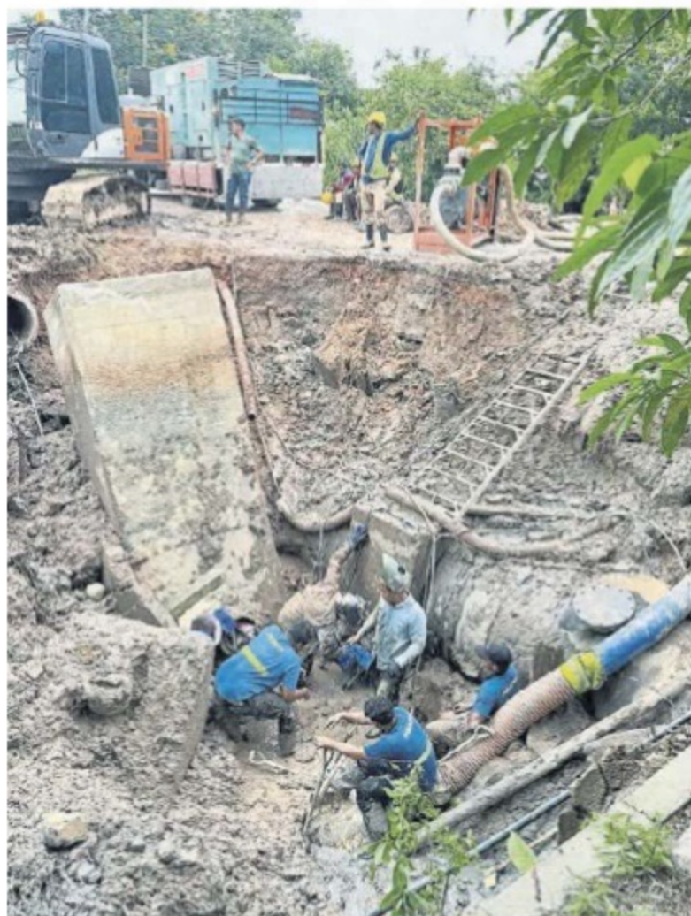
■檳供水机构已启动紧急应对机制，展开维修工程，预计周二晚上8时35分完成，并将分阶段恢复水供予受影响用户。
